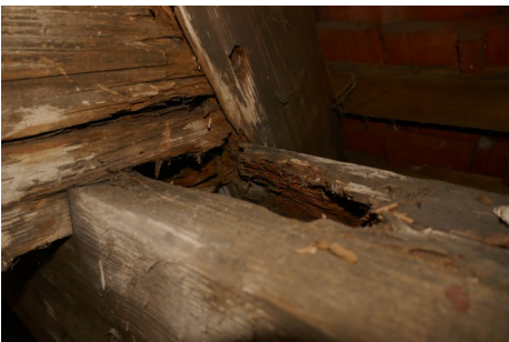
Fäulnisschäden am Dachbalken
