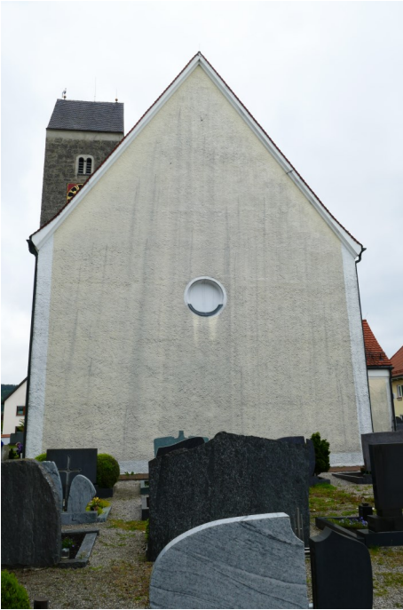
Westseite der Pfarrkirche: Verschmutzung, Algenbewuchs und Putzschäden
