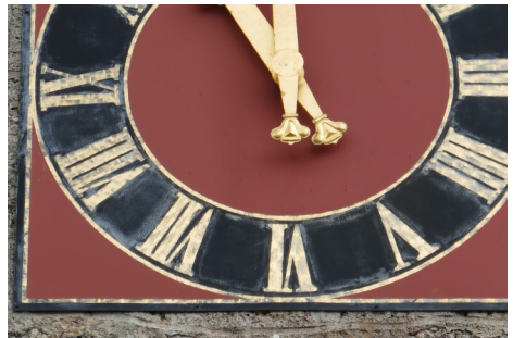
Schäden an den Zifferblättern
