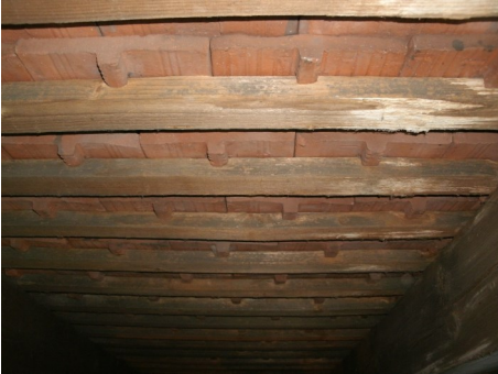
Dachplatten, zum Teil morsch und durchhängend
