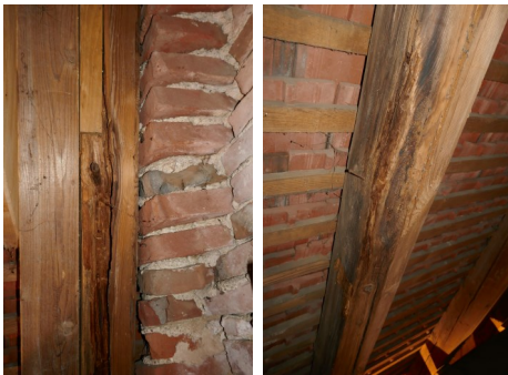
Links: Dachsparren an der südlichen Giebelwand, verfault, vorläufig gesichert 2007 Rechts: Geschädigter Dachsparren, teilweise morsch
